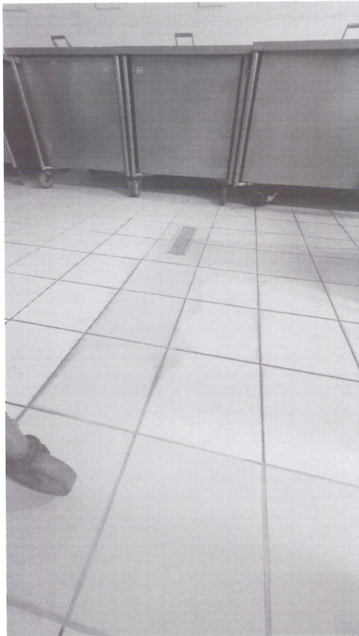
Figura 4 – Ambiente de sala de tanques em que precisa ser feita adequação de esgoto para escoamento adequado de água.
