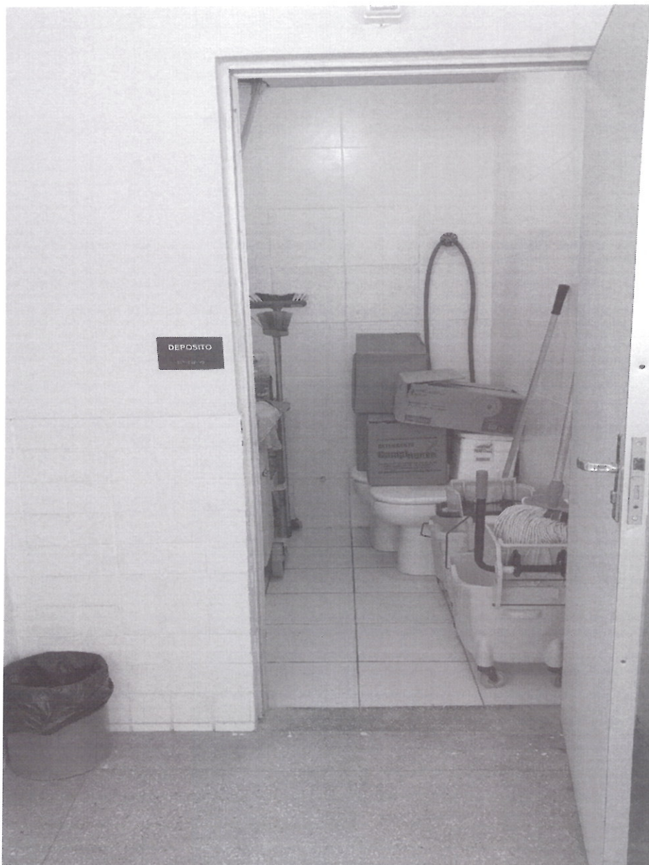
Figura 1 – Situação do atual espaço utilizado como DML – Espaço inicialmente destinado a banheiro para portadores de necessidades especiais.
