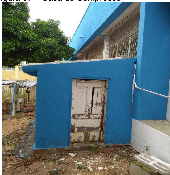
Figura 07 – Casa do Compressor
